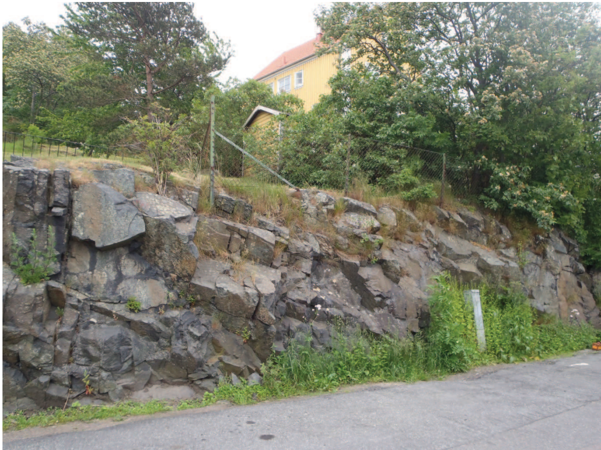
Foto 6. Bergskärning mot Prospect Hillgatan, vid nr 12 som syns högst upp i bilden. Bergskärningen är uppsprucken med lösa block. Bilden tagen mot öster.
